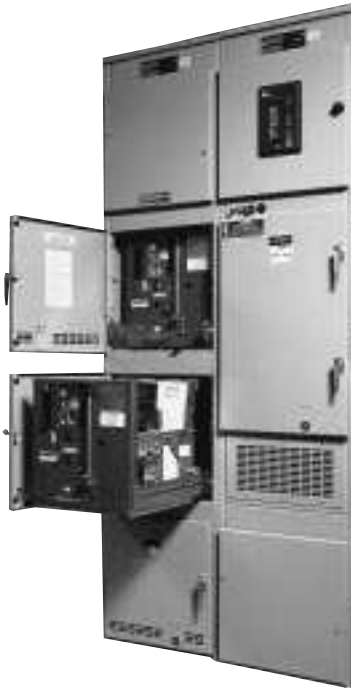
DS Switchgear Assembly
