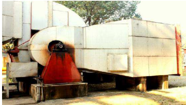
Figure 2.10: FD fan for 150 MW & 15.75 KV unit 4.
