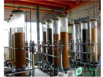
采用阴床，阳床，混床 去离子超纯水处理设备
