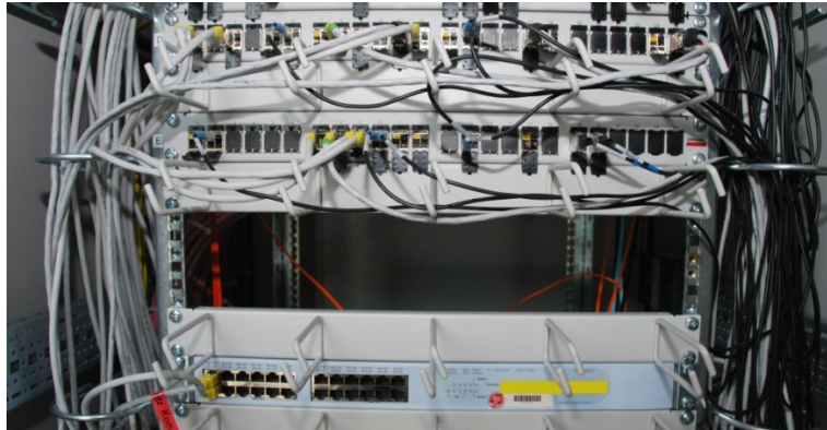
Abbildung 5 Verteilerschrank eines mittelgroßen Netzwerks mit 2 Verteilerfeldern (oben) und Netzwerkschwitch (unten)
