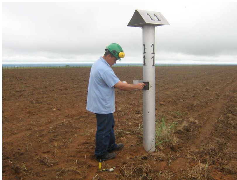
Figura 12. Poste para toma de potencial en el tramo Apiay- Bogotá.
