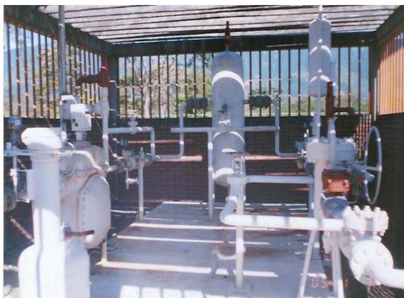
Figura 5. Estación de regulación y medición o city gate de Cumaral
