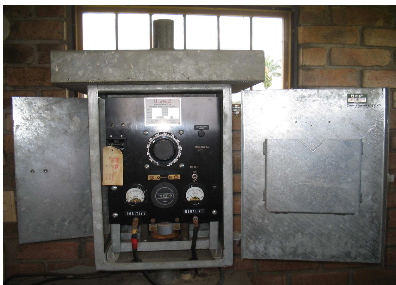
Figura 9. Rectificador de la Llanerita
