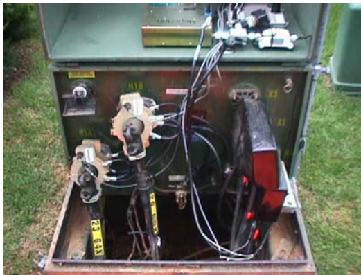
Figura 3.3 Unidad de acoplamiento instalada en una subestación de media tensión 24
